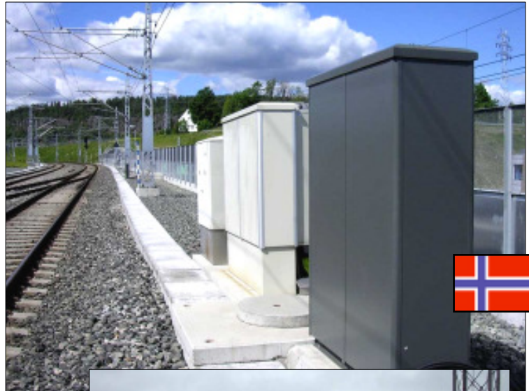
INSV NIEDERSPANNUNGSVERTEILUNG HAUG (NORWEGEN)
